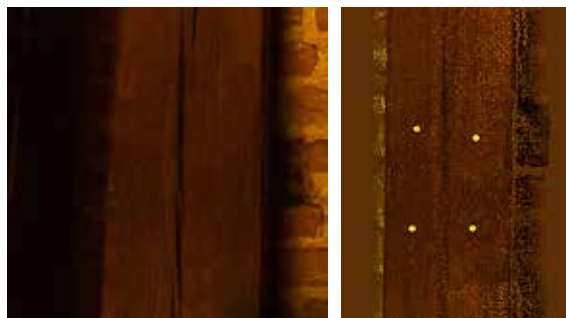
► Pęknięcie słupa: po lewej zdjęcie cyfrowe, po prawej chmura punktów
