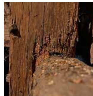
► Zniszczenie drewnianego elementu konstrukcji spowodowane przez owady
